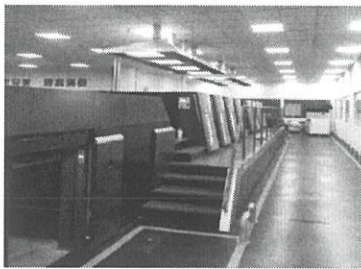
图 3.2-1 印刷车间废气收集和排放现状图
